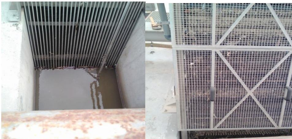
Figure III.3: dégrilleur manuelle et automatique.
