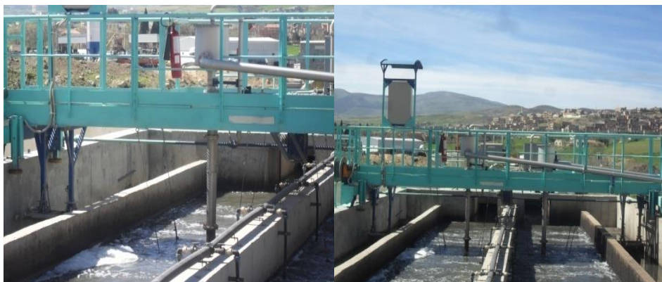
Figure III.3 : Bassin de désuilage/dessablage
