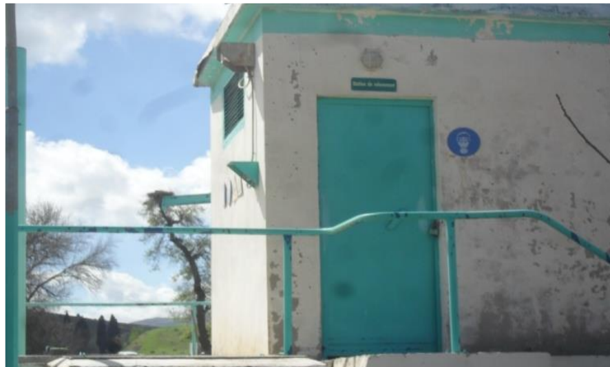
Figure II.5 : Le poste de relèvement de la station d'épuration
