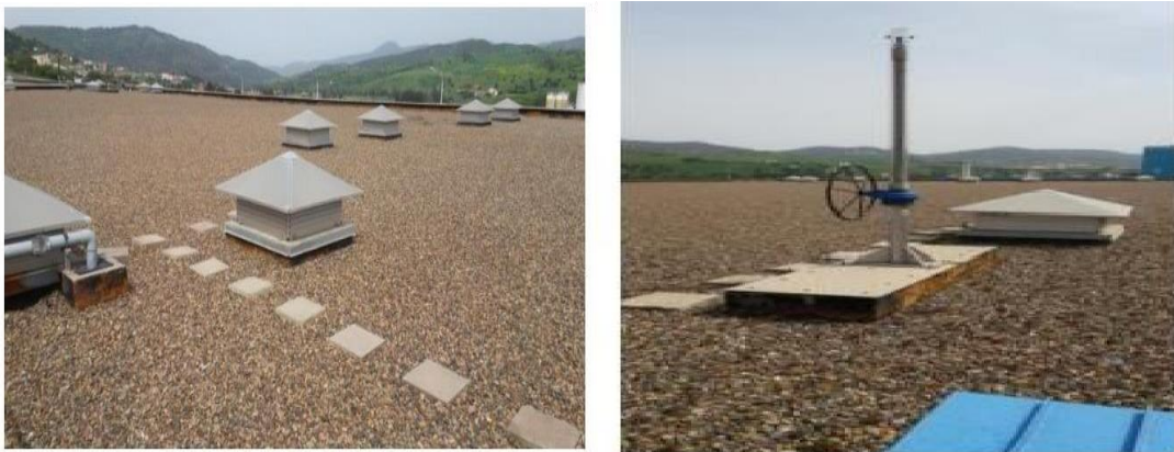
Figure N°18 : Les points d'injection de chlore au niveau de réservoir.
