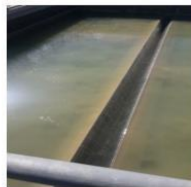
Figure N°16 : Les filtres en état de lavage
