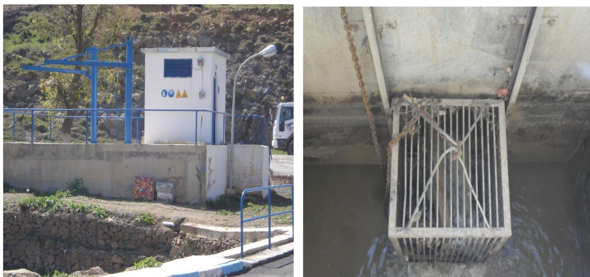
Figure I.2 : Poste De Relèvement
