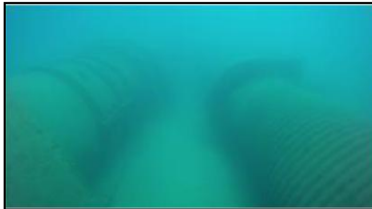
Figure II.1 : Tuyaux de captage de l'eau de mer.
