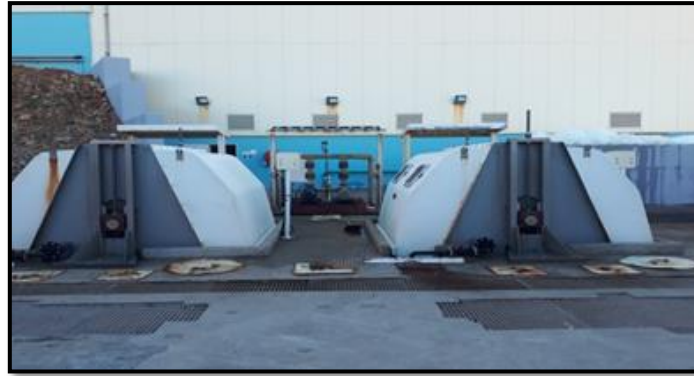
Figure II.2: les deux beaudrey de la station (filtration mécanique).
