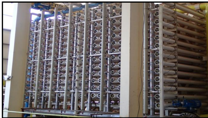
Figure II.5 : un rack dans le système d'OI.
