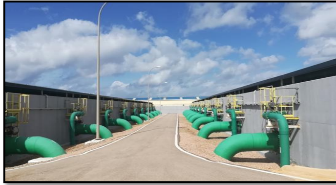
Figure II.3: filtres à sables.
