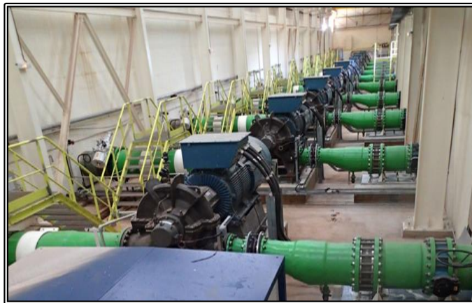
Figure II.7: Pompe HP intermédiaire.
