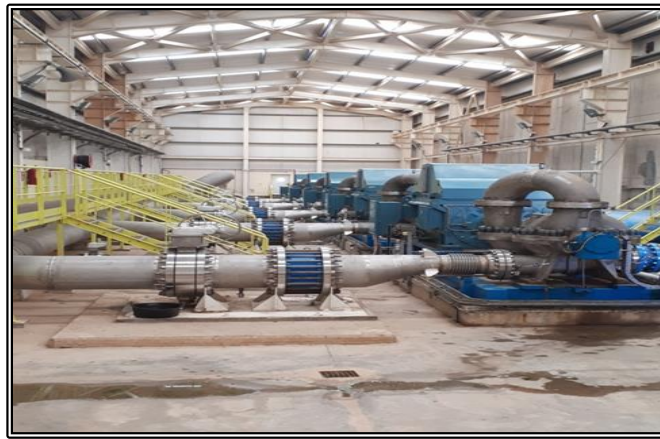
Figure II.20: Pompe HP pour la distribution de l'eau produite.
