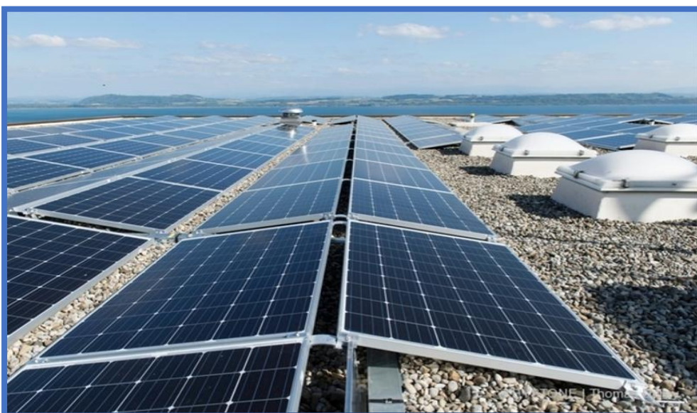
Figure ( I.5 ) :Les panneaux solaire[7].
