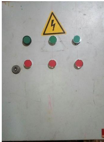
Figure II.28 : L'armoire de commande.
