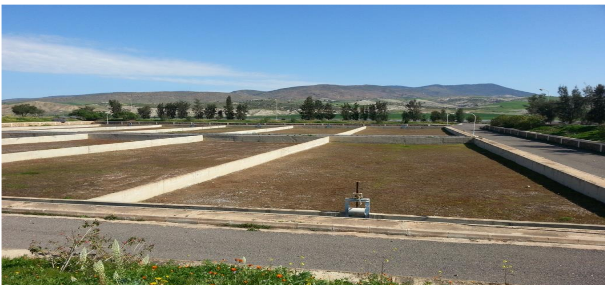
Fig. 1.12 : Bacs des boues.
