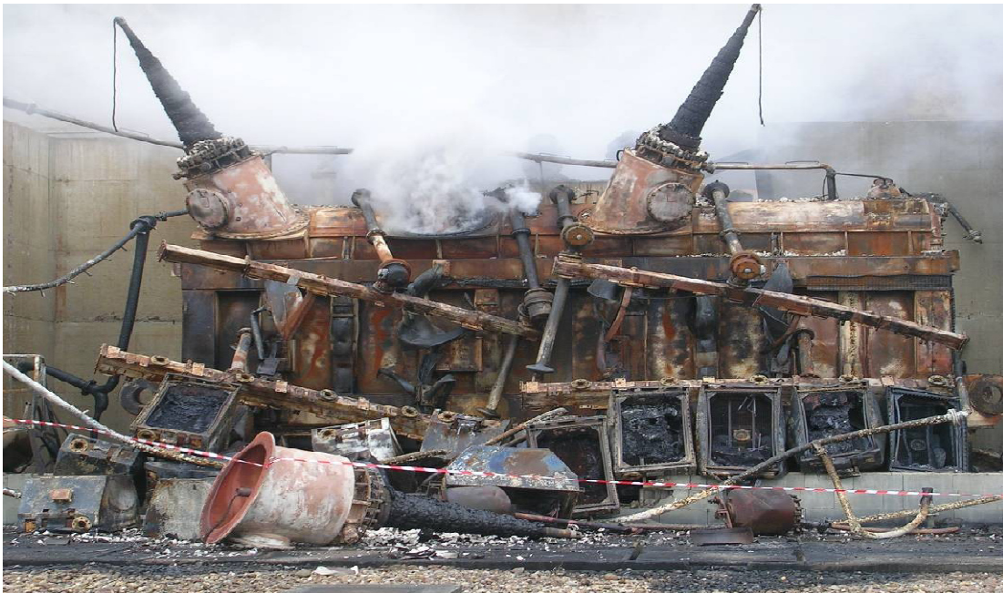
Figure(I.13) : Explosion de transformateur.[2]
