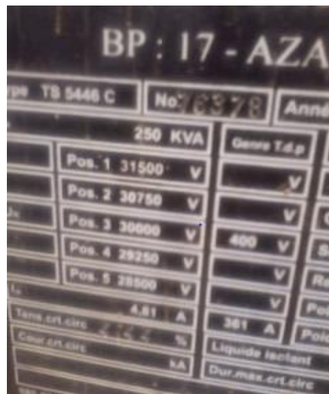
Figure 2-16 : Réglage de tension sur transformateur HTA/BT
