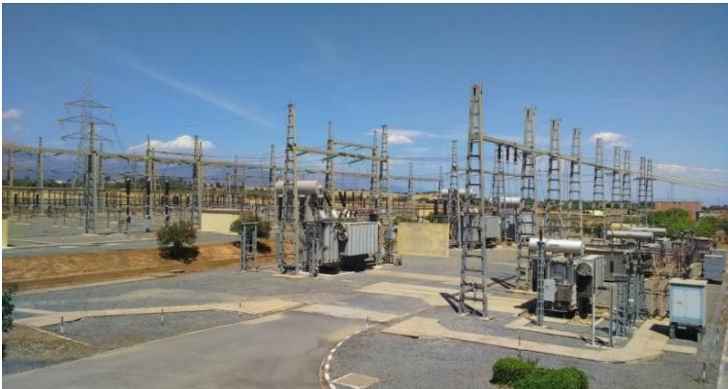
b- Transformateurs de puissance 220/60/10KV et 60/30KV
