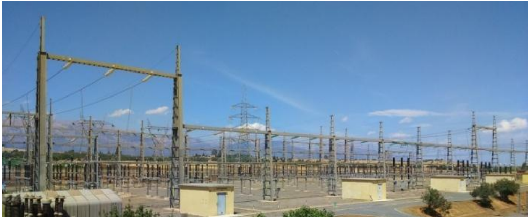
a- Etage 220KV
