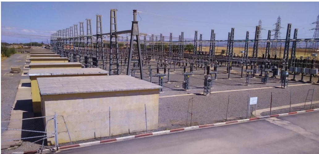
c- Etage 60 KV
