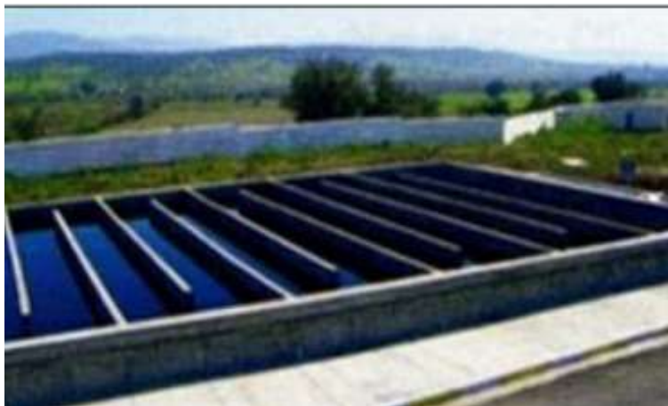
Figure 21: Bassin de désinfection (Tabet, 2015)
