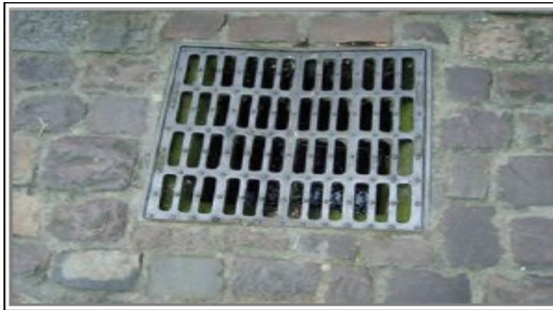
Figure V.14 : Bouche d'égout à grille
