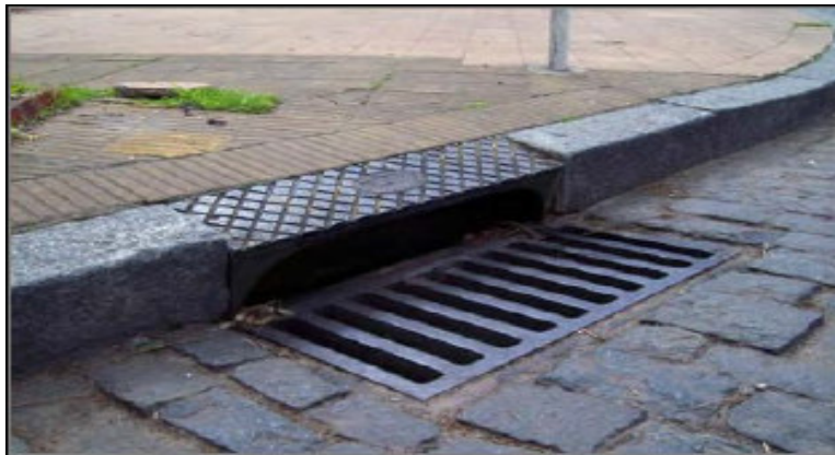
Figure V.15 : Bouche d'égout à avaloir
