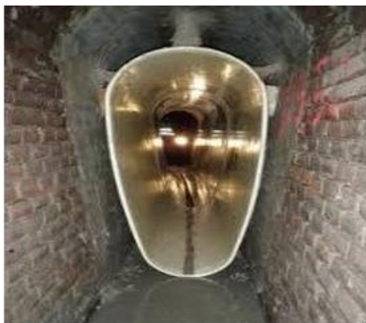
Figure 40 Conduite ovoïde en PRV.
