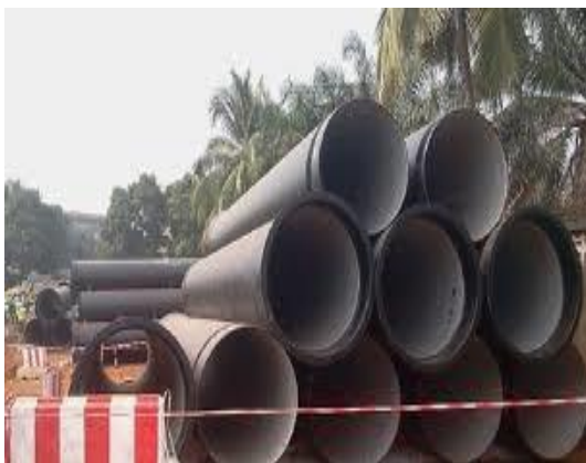
Figure 38 Conduite circulaire en PRV.
