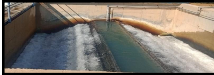
Figure I. 9: Cascade d'aération de la station de traitement Tilesdit
