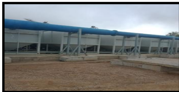
Figure I. 14 : Décanteurs de la station de traitement monobloc
