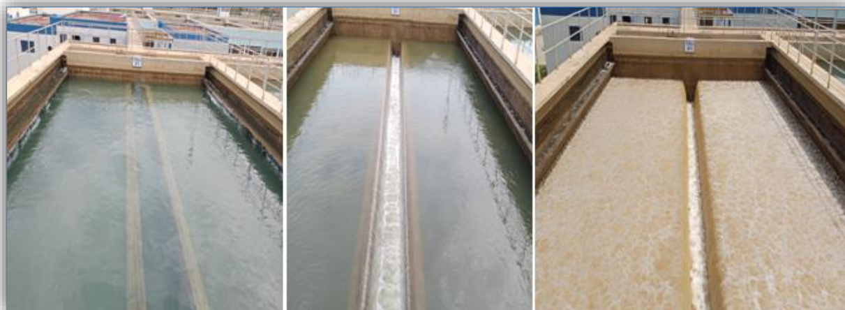
Figure III. 8 : Photo de lavage du filtre Aquazur V.
