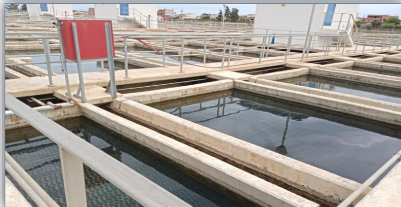
Figure II. 10: Photo d'un décanteur pulsateur de la station de Boudouaou.
