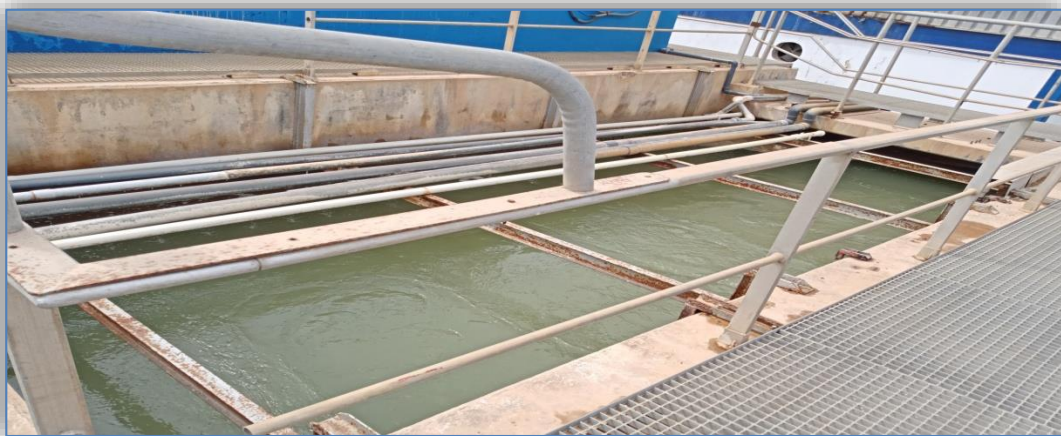
Figure II. 7: Photo chambre du mélange des réactifs
