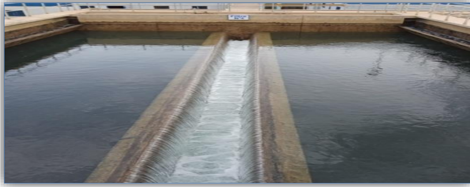
Figure II. 11 : Photo d'un filtre Aquazur V de la station de Boudouaou.
