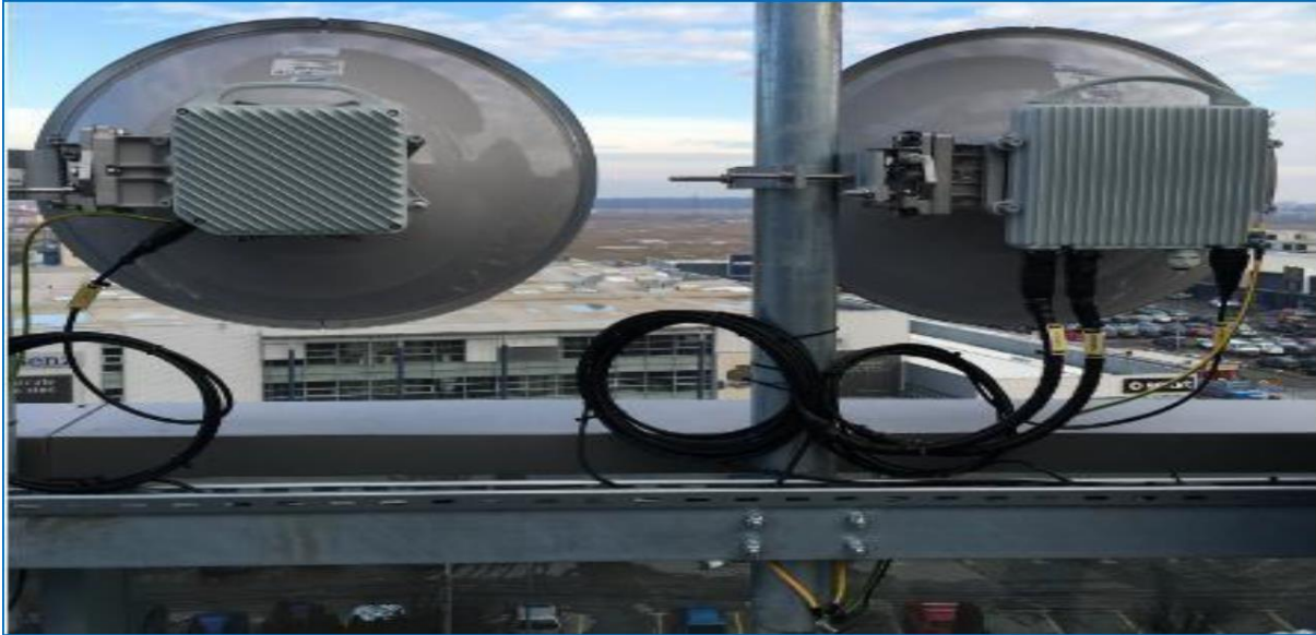
Figure III.8 : l'installation des antennes SDB
