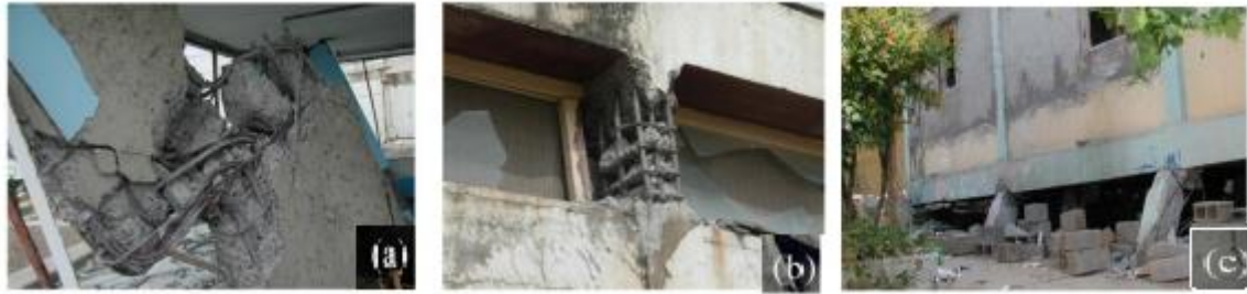
Figure I-3. Rupture dans un poteau (Séisme de Boumerdès du 21/05/2003)
