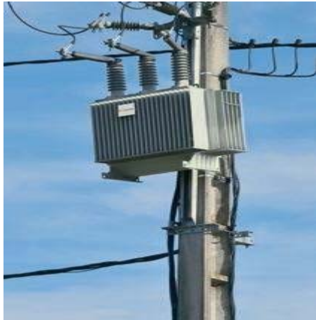
Figure 2. 6. Transformateur sur poteau (TPC)
