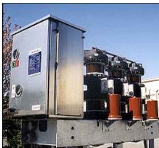
Figure (30) : disjoncteur HT
