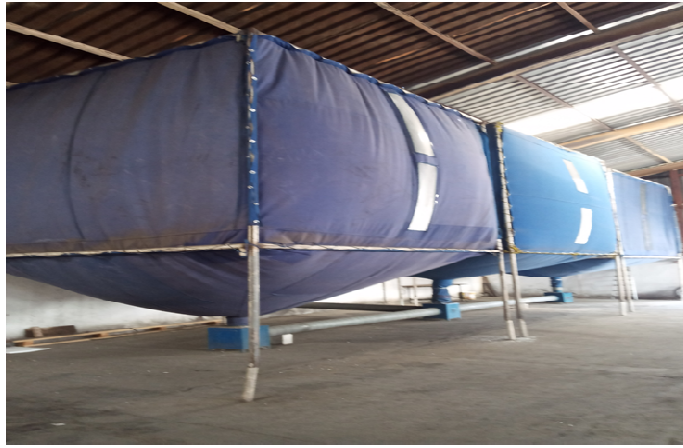
Figure II. 13: Le stockage du polystyrène Dans les Silos.
