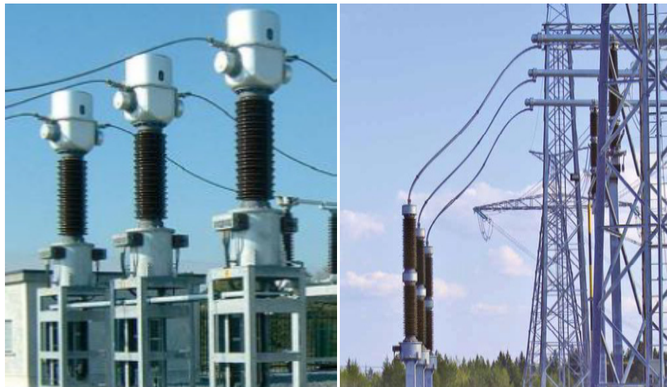
(a) Transformateur de courant
