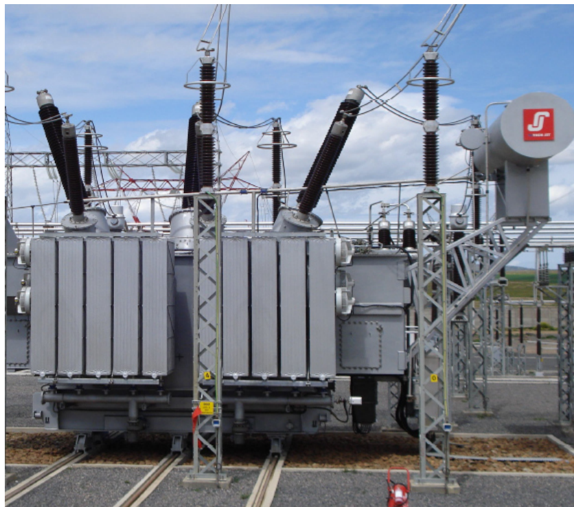
Figure II.6 : Transformateurs de puissance [33]
