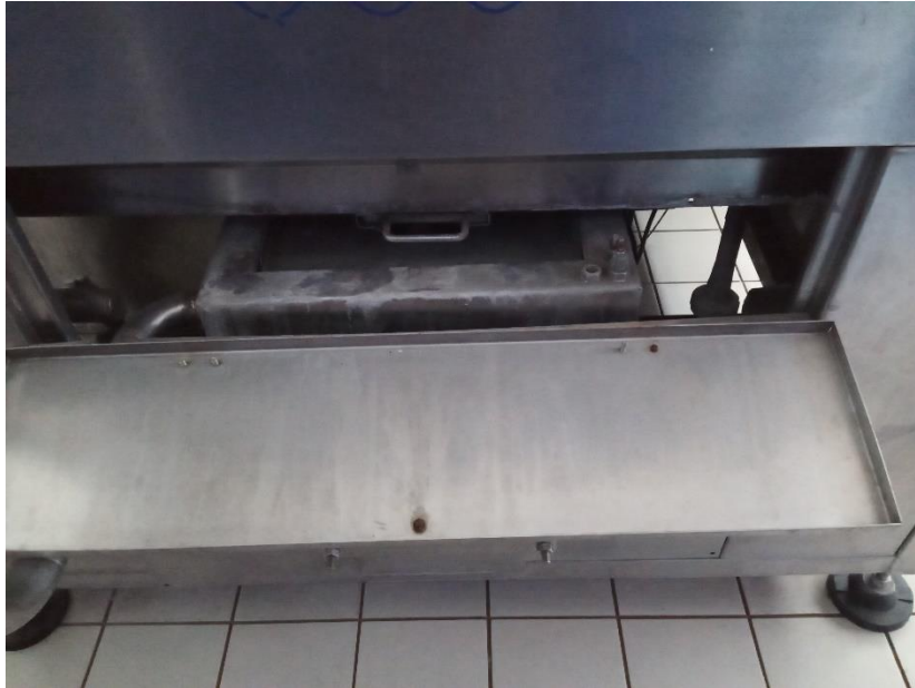
Figure IV.11 : Réservoir de l'eau chaude avec clore.
