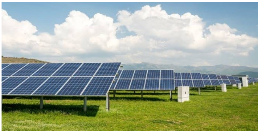
Figure 1.3 : image correspondante à un panneau photovoltaïque.
