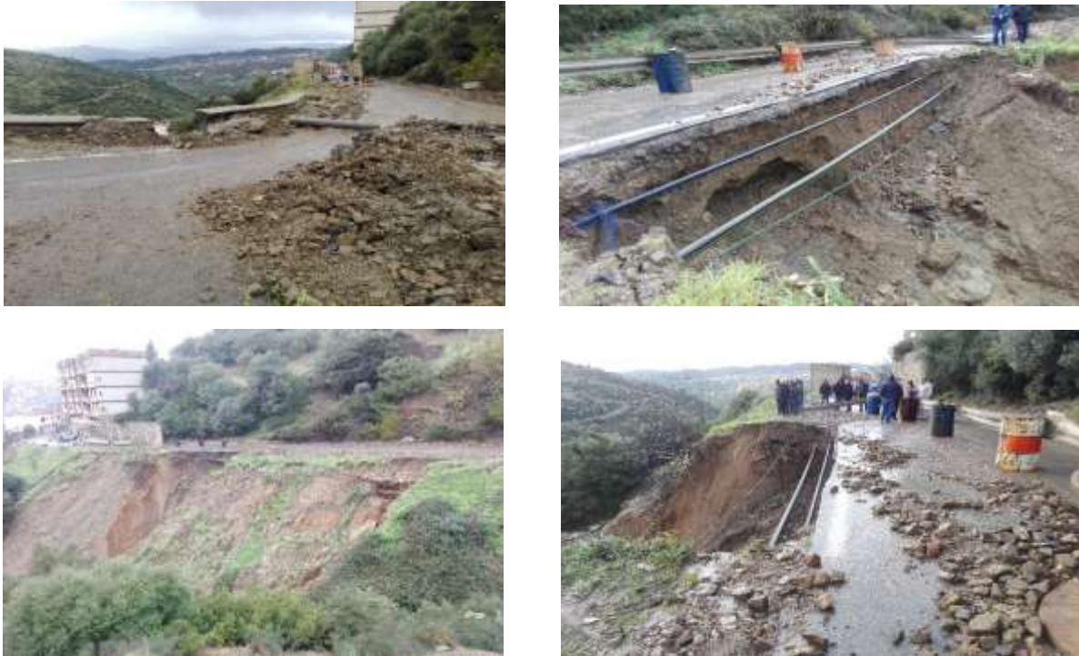
Figure III. 1: photos de route déstabilisée.
