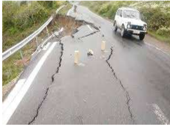
Figure I. 2 : Effondrement d'une route suite à un mouvement de terrain.
