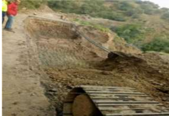
Figure III. 3: Terrassements montrant la nature schisteuse du terrain.
