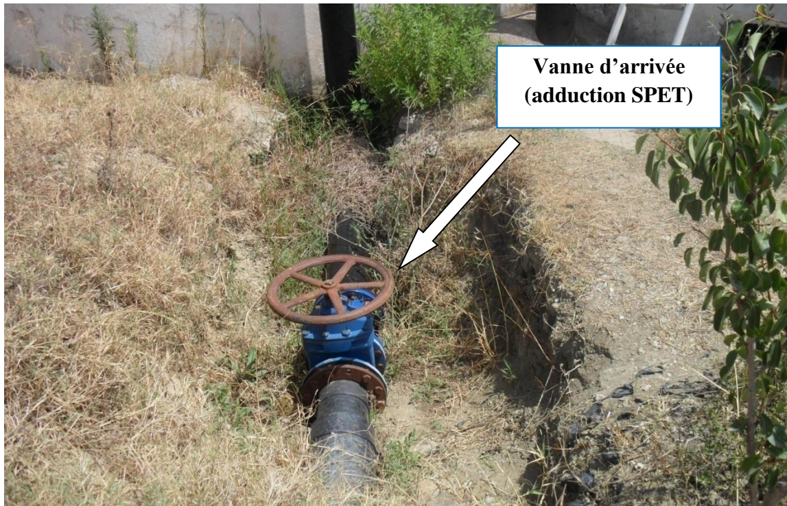
Figure. V.7 : Vanne d'arrivée (adduction SPET).
