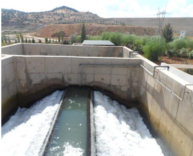
Figure I.1 : Cascade d'aération gravitaire.
