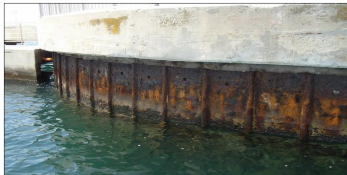
Figure I.28 : Corrosion des palplanches.
