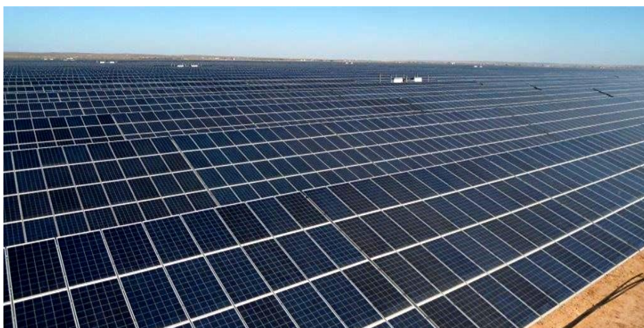
Figure III.18. Centrale pilote Photovoltaïque d'Oued N'Chou 1,1 MWc
