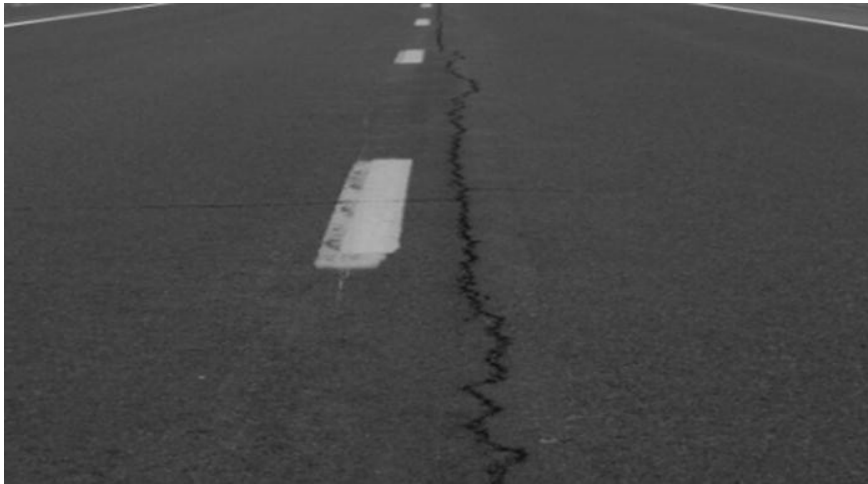
Figure II.2 Exemple d'une fissure longitudinale.
