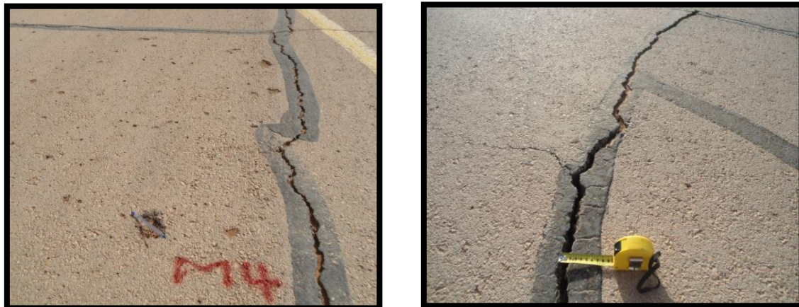
Figure III.1 Les dégradations au niveau du la piste 05/23
