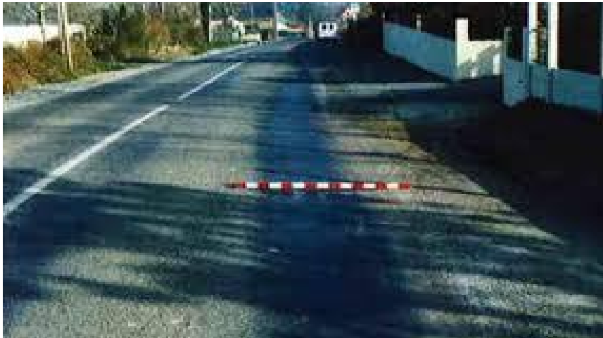
Figure II.22 Exemple d'un glaçage.
