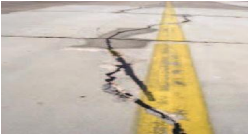
Figure II.15 Exemple d'une fissure.
