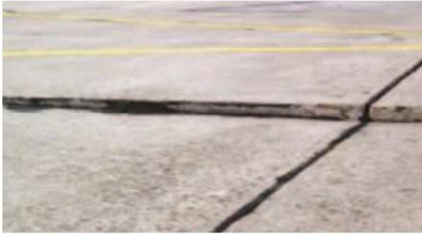
Figure II.24 Exemple d'un soulèvement des dalles.
