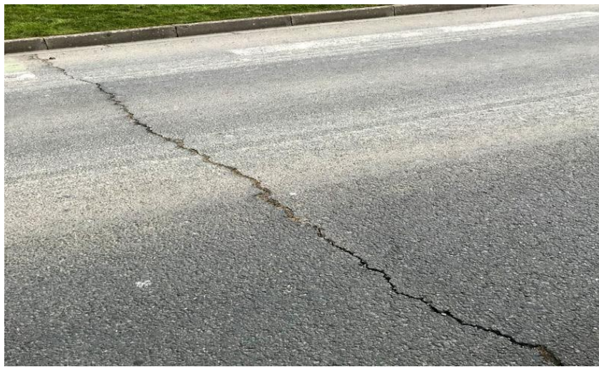
Figure II.1 Exemple d'une fissure transversale.
