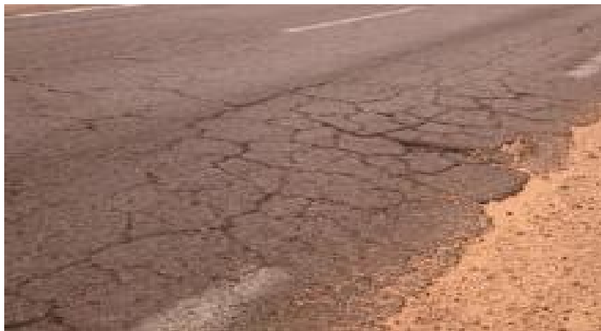
Figure II.3 Exemple d'un faïençage.
