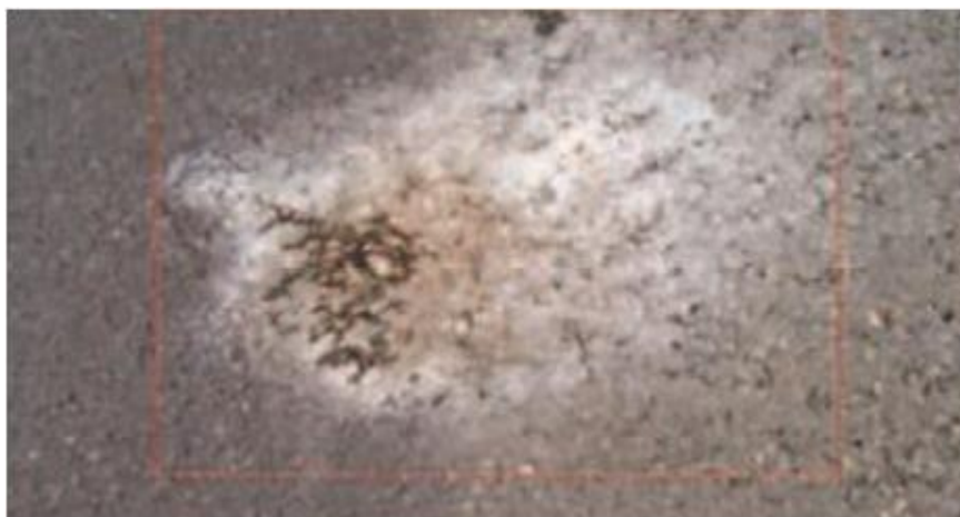
Figure II.23 Exemple d'une remontée de mortier.
