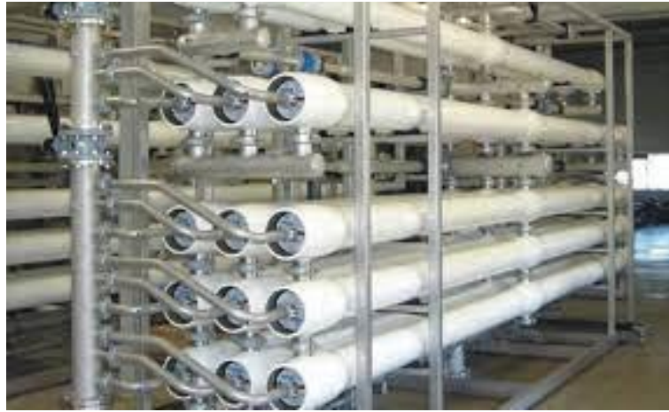
Figure 24 : Châssis d'osmose inverse
