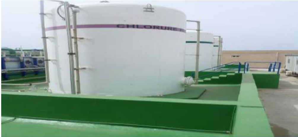
Figure 21 : Réservoirs des produits chimiques
