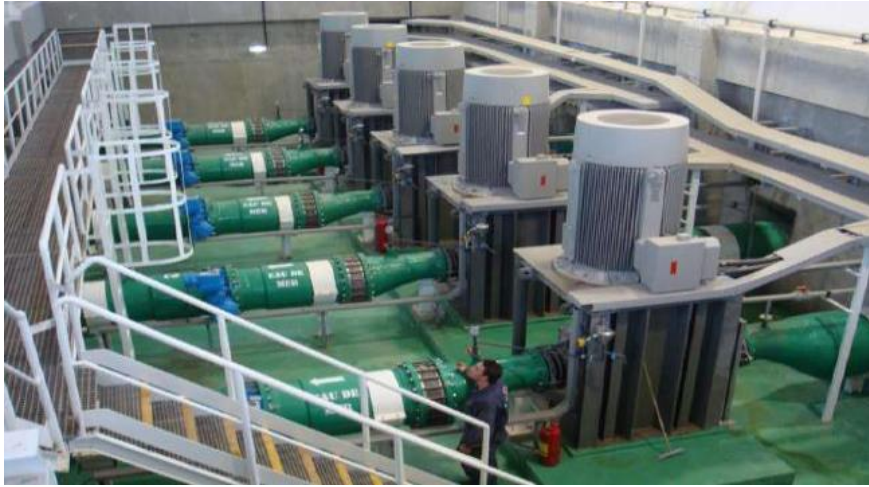
Figure 20 : Station de pompage de l'eau de mer
