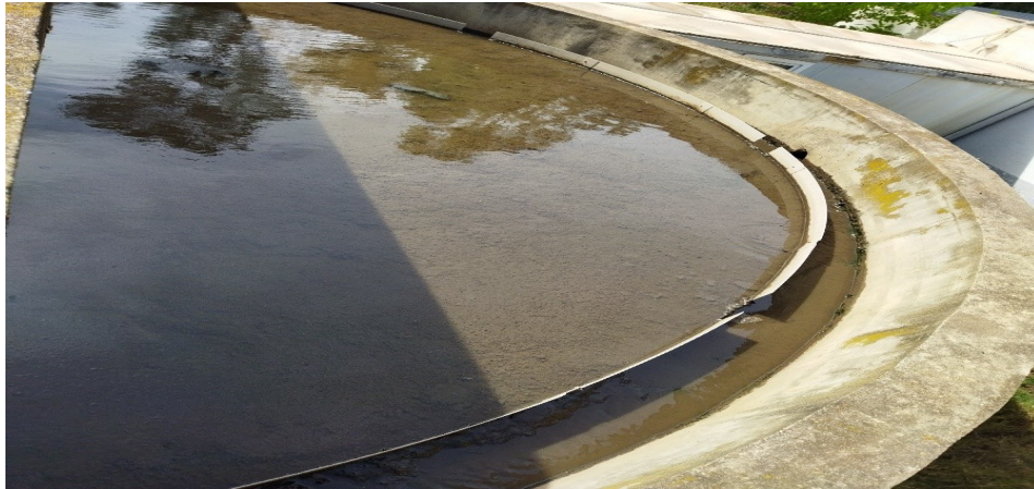
Figure II.11: Les bassins d'épaississement de la boue
