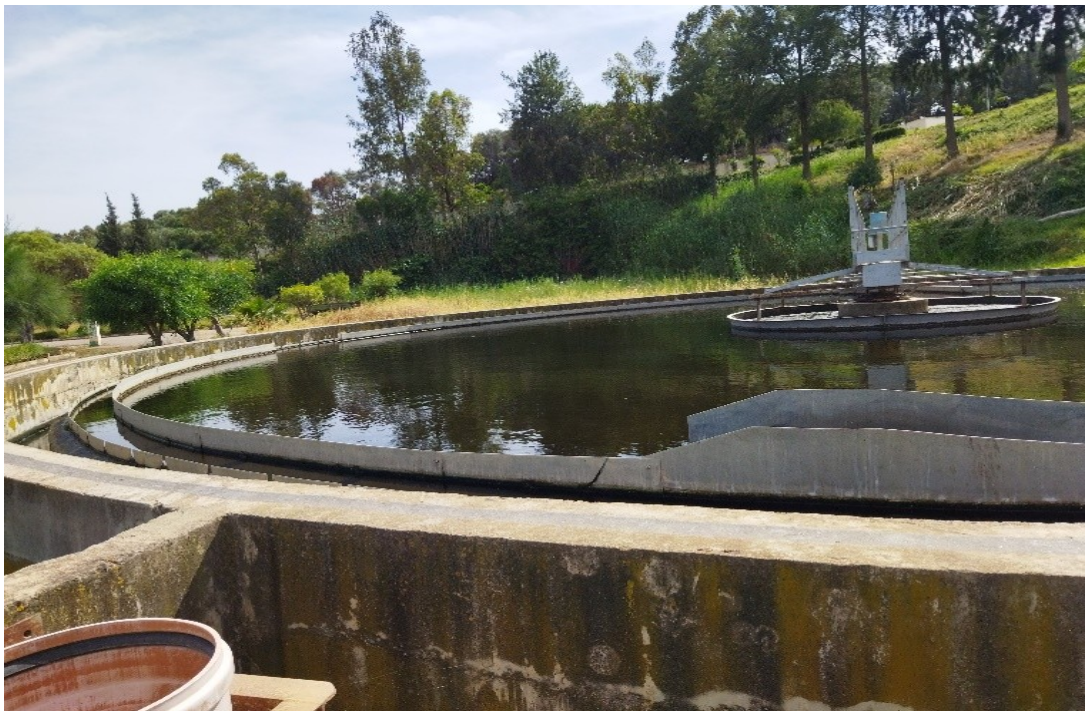
Figure II.9: Les bassins de décantation
