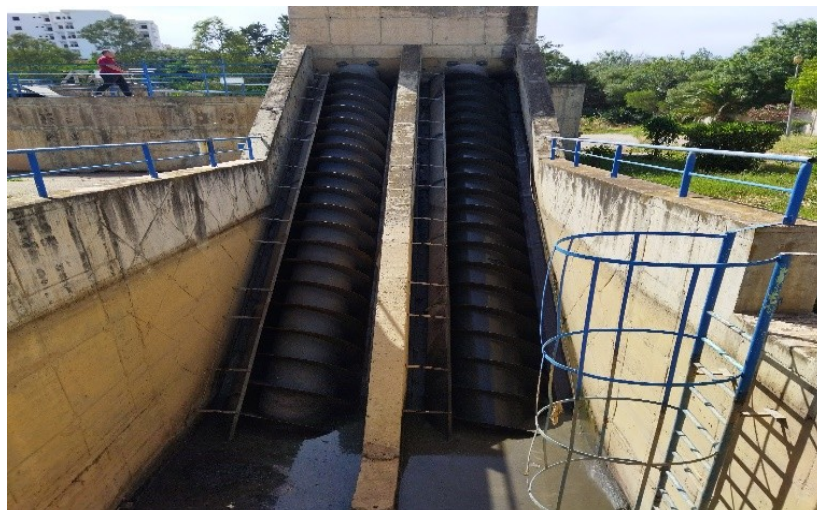
Figure II.3 : Le relevage des eaux usées (vue en face)
