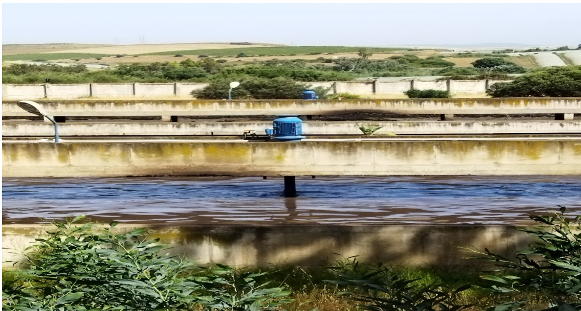
Figure II.8: Les bassins d'aération
