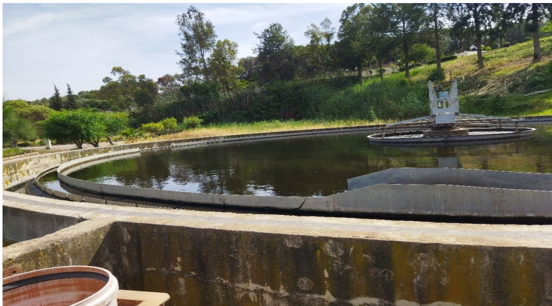
Figure II.9: Les bassins de décantation
