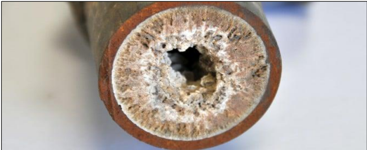
Figure II.1: L'entartrage dans une conduite.
