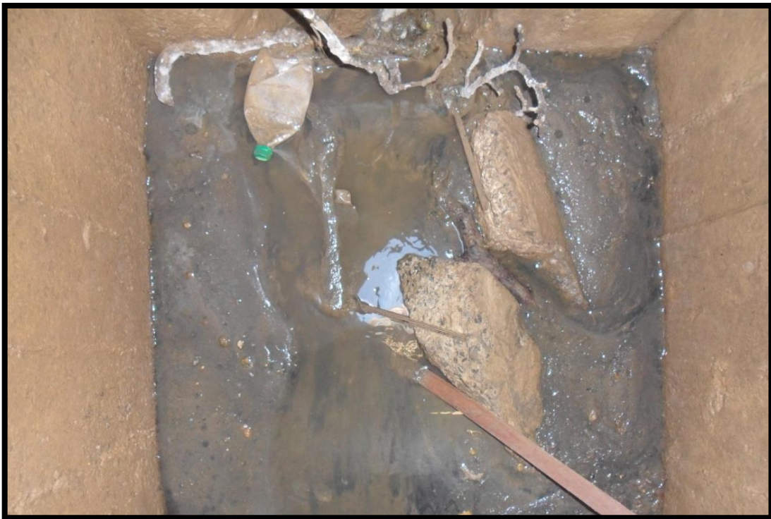
Figure 17. Colmatage des sorties des collecteurs dans le regard (Image )
