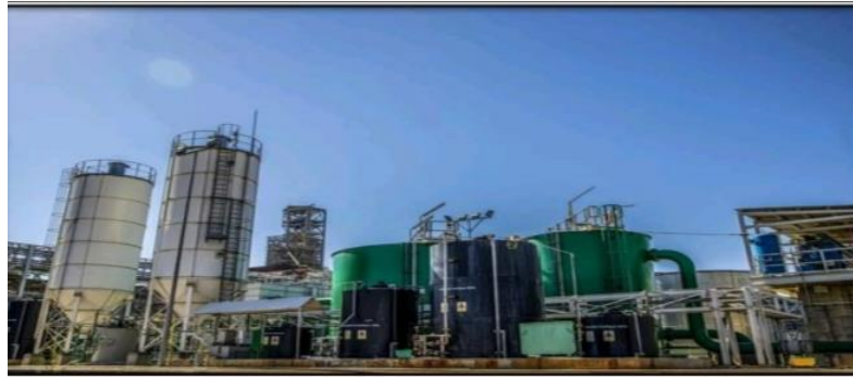
Figure I-9 : Station générale de traitement des eaux WTP.
