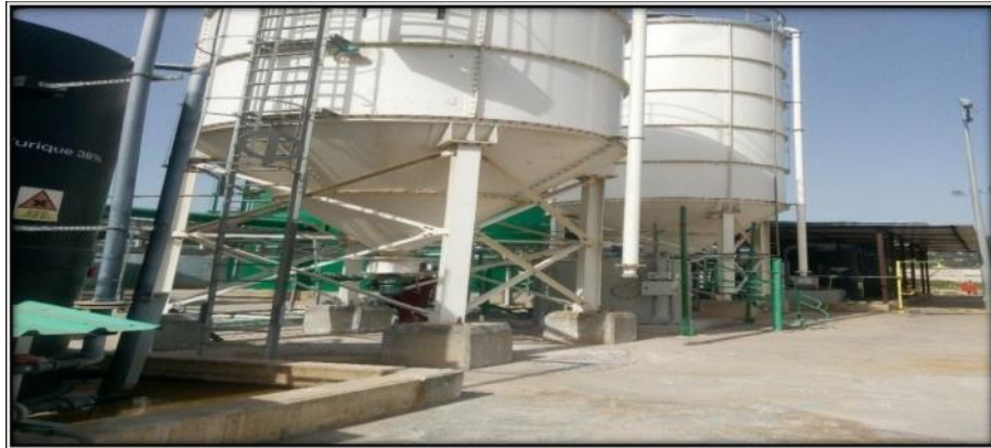
Figure II.4 : La chambre de décarbonatation.
