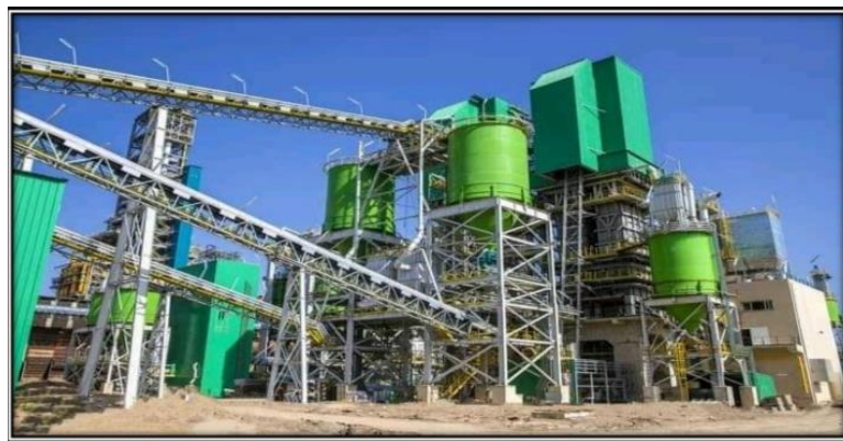
Figure I-7 : L'unité de traitement de chaux LMP.
