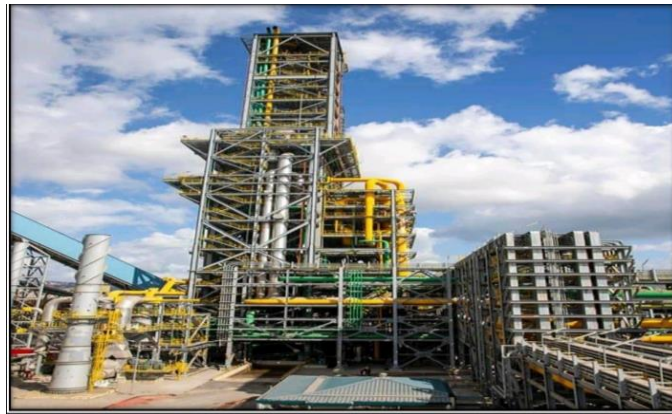
Figure I-3 : Le four d'unité de production DRI.
