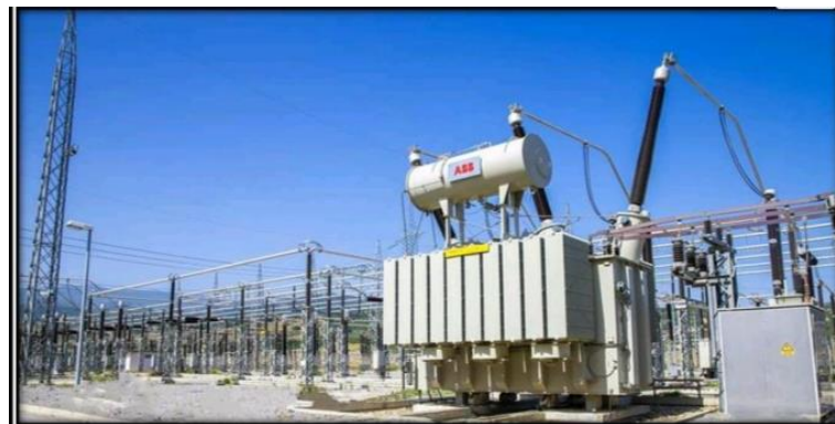
Figure I-10 : Sous-station électrique MRSS.
