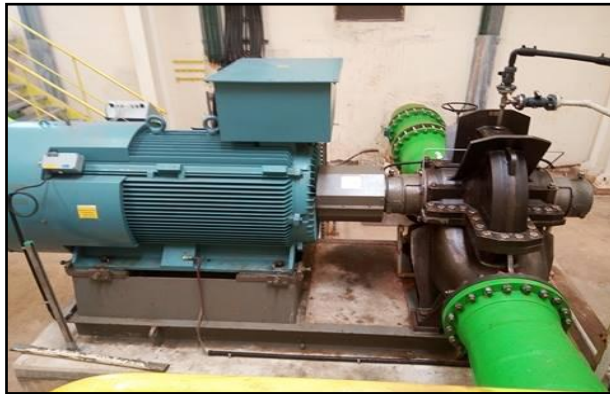
Figure III. 5: Pompe à haute pression
