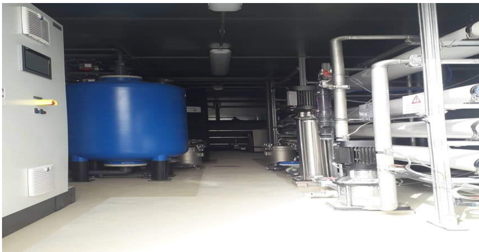
Figure III.4 : chambre de traitement de lixiviat par Osmose Inverse
