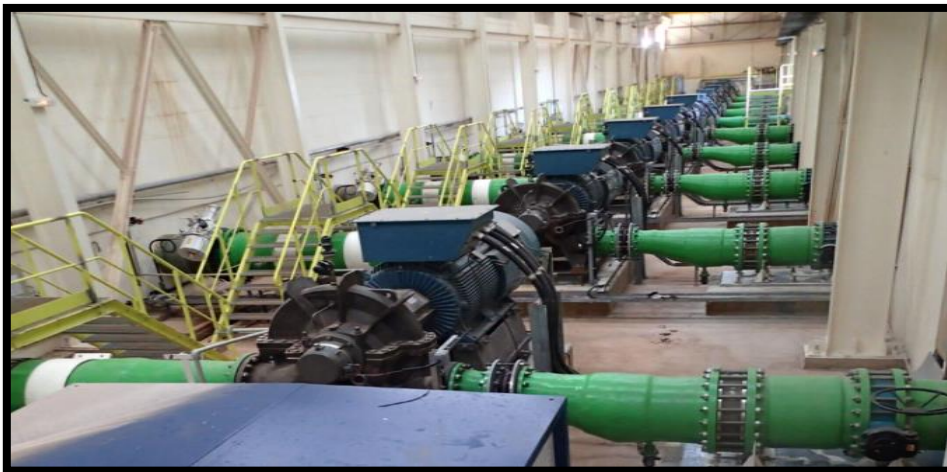
Figure 9: Pompage (4 pompes en service et 1 secours)
