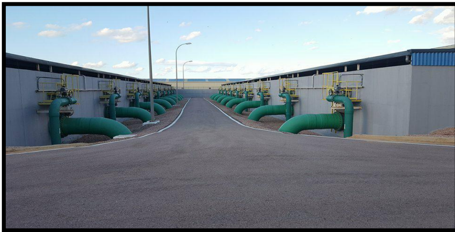
Figure 8: Filtres à Sable
