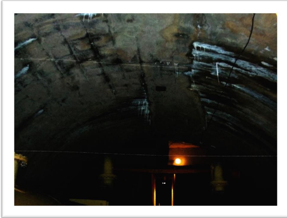
Figure II.4 traces de lessivage du béton dans la galerie
