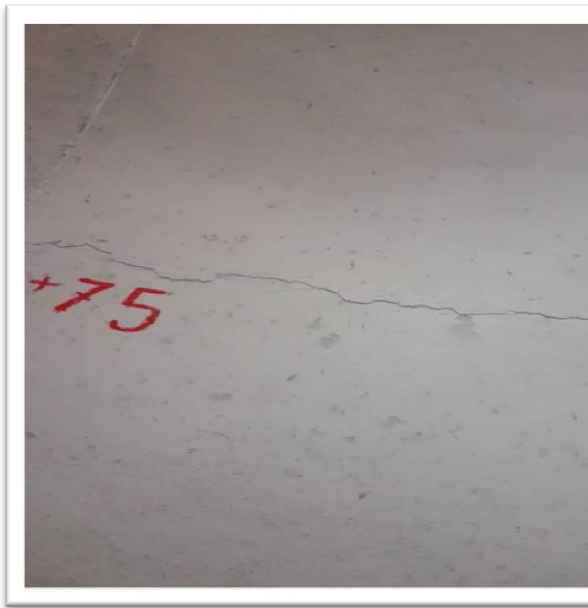
Figure II.1 Fissure N°3 au niveau de la galerie
