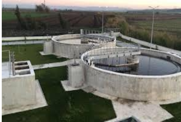
Figure I.5 : Bassin de décantation.
