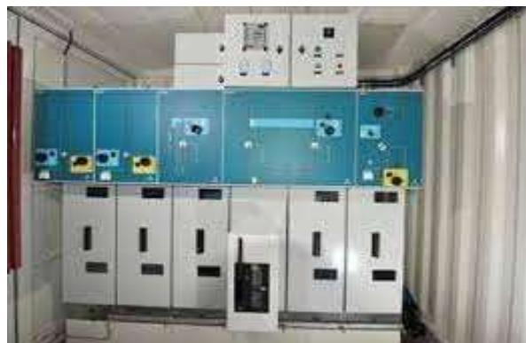
Figure I.11. Poste intérieur HTA/BT [3]
