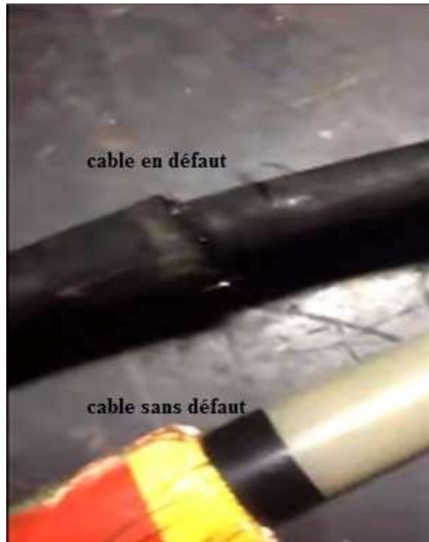
Figure III.10. Défaut sur un câble souterrain
