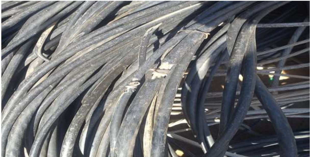
Figure III.11. Câble aérien endommagé (claquage)
