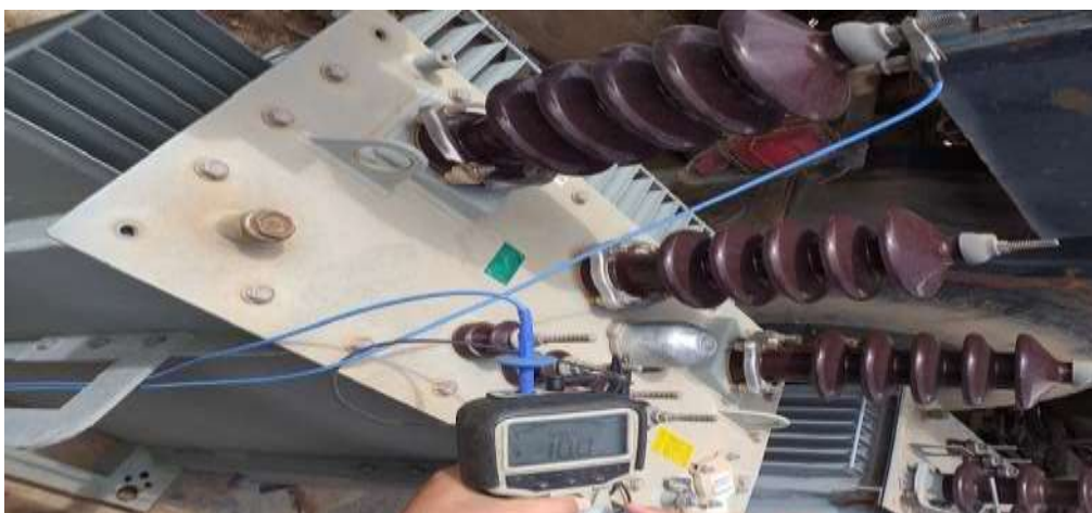
Figure III.17. Branchement de l'appareil de mesure de continuité
