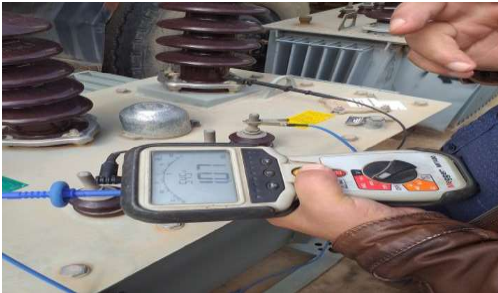
Figure III.20. Résultat de mesure d'isolement (cas de défaut)
