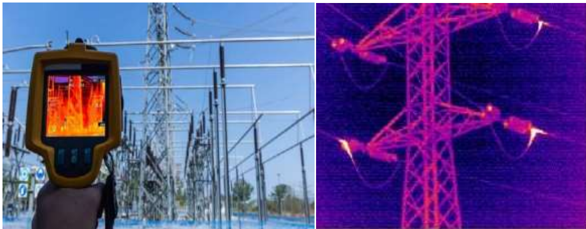
Figure III.13. Défaut électrique détecté sur la camera thermique [20]
