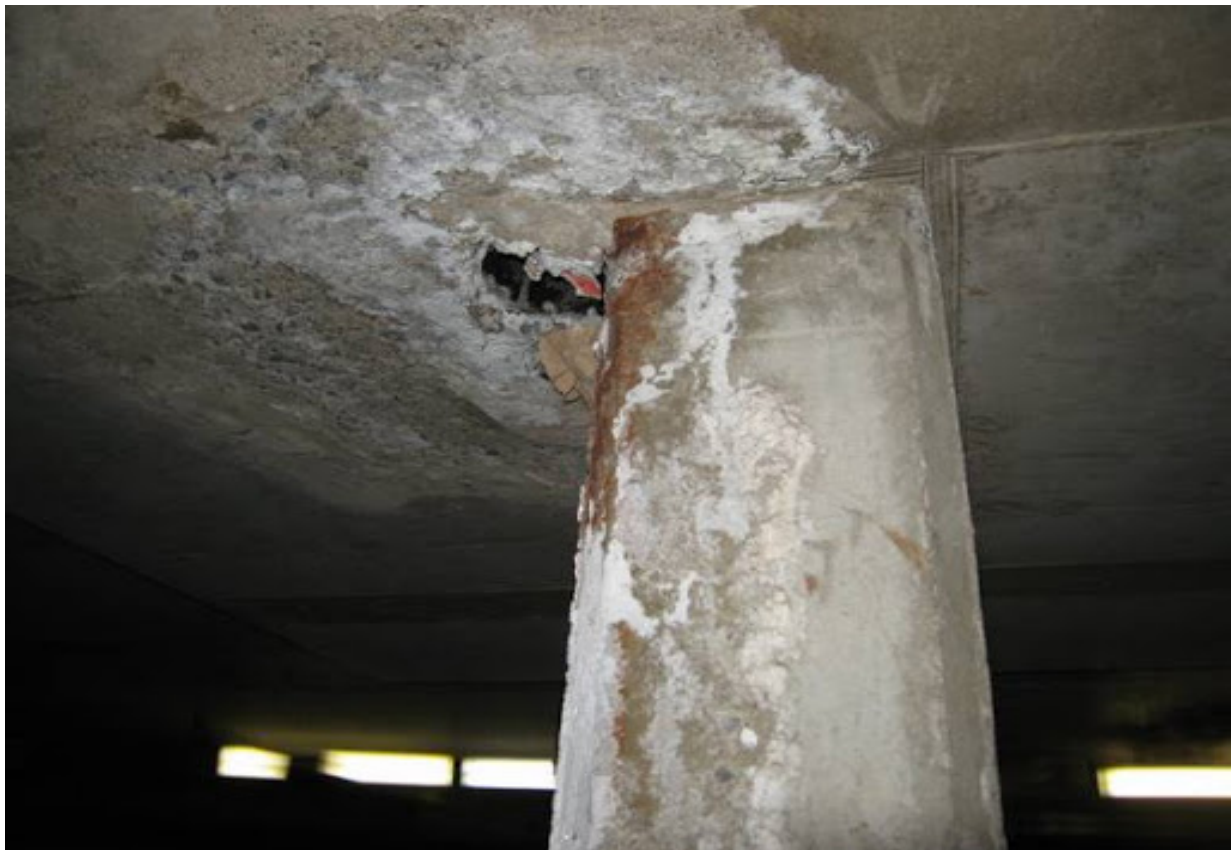
Figure [2.3] - dégradation du béton
