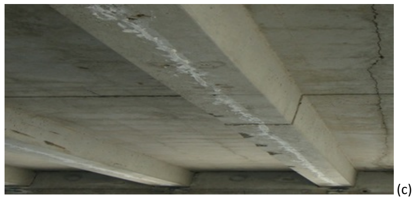
Figure [4.1] - Exemples de fissures dans le béton : a) Microfissures typiques ; b) Inspection conventionnelle des fissures des ponts ; c) Fissures le long d'une dalle dans un centre commercial.
