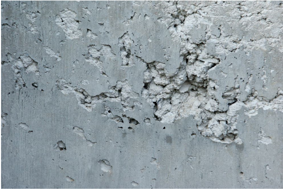
Figure [2.2] - ségrégation du béton
