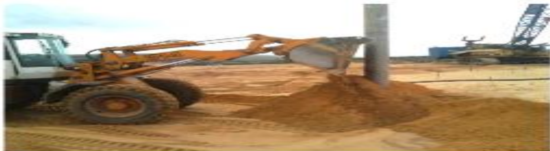
Figure I.10 : Remplissage de l'affaissement conique par un matériau d'apport (Barrage -Harka- TUNISIE)
