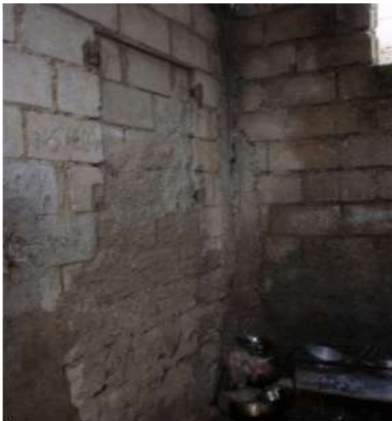
Figure II.14: manque de chaînage.
