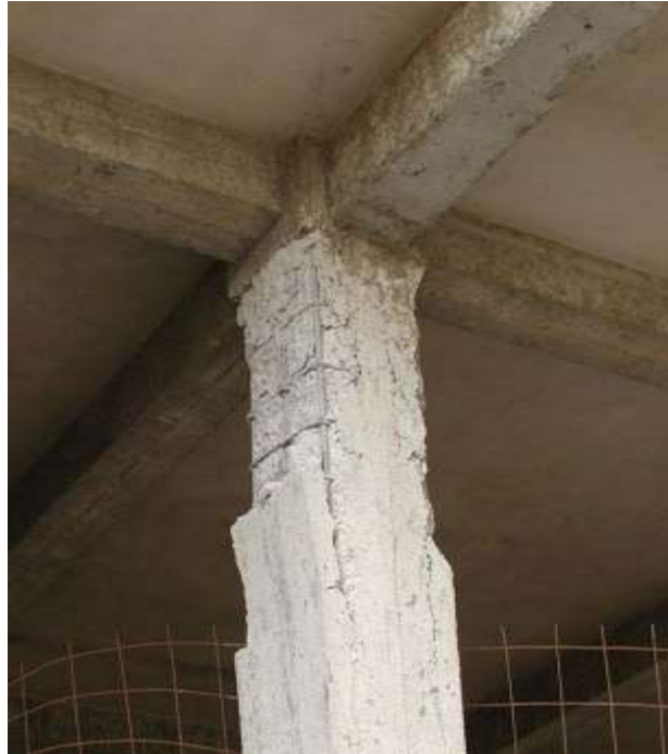
Figure I.14: Décollement de l'enrobage.
