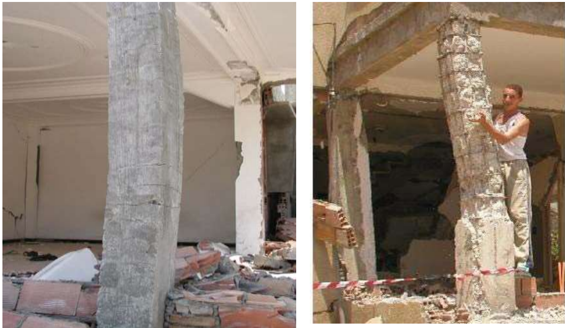
Figure I.13: Flambement des poteaux (source de la photo à droite : rapport AFPS).
