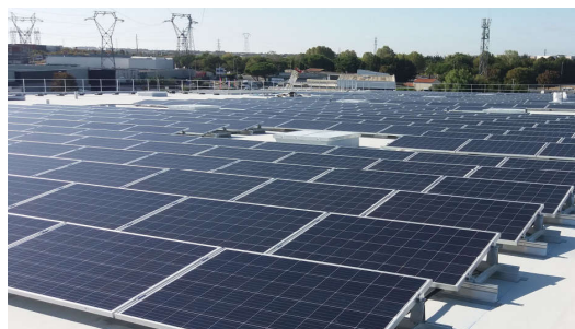
FIGURE 1.8 – Générateur solaire photovoltaïque
