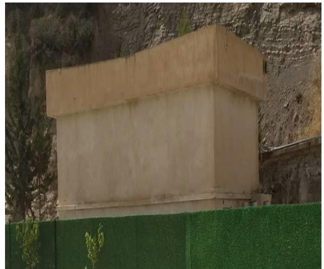
Figure II.11 : Réservoir de refroidissement
