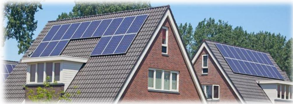
Figure (II.22) : Panneaux photovoltaïques sur toit incliné de maison. [15]
