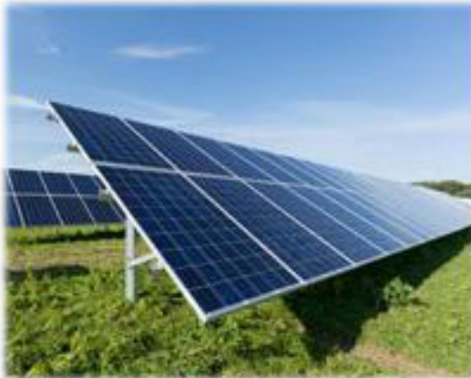
Figure (II.24) : Panneaux photovoltaïques au sol sur structure. [15]
