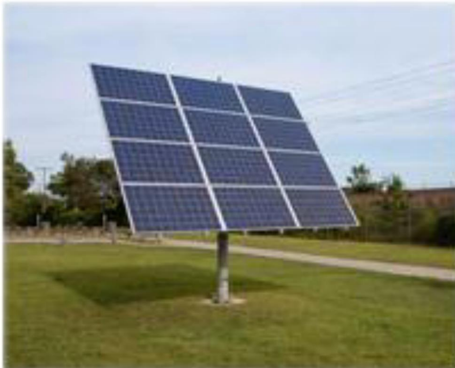
Figure (II.25) : Panneaux photovoltaïques sur suiveur solaire. [15]
