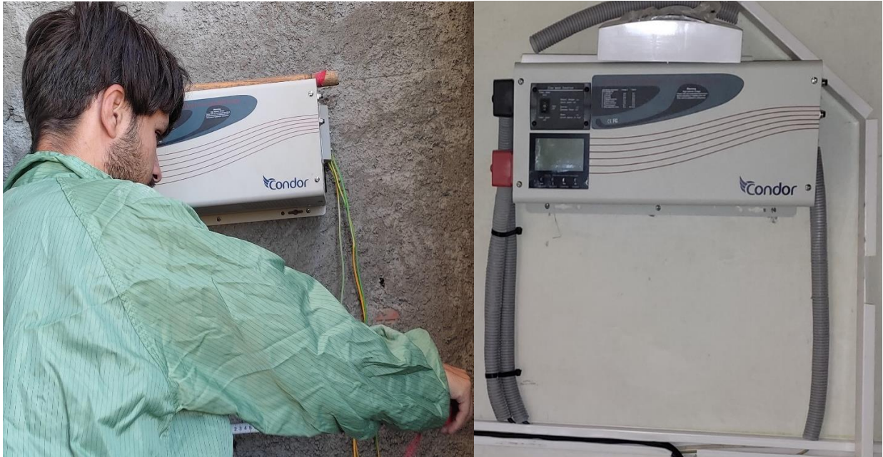
Figure 37: Onduleur a utilisé pour l'installation en courant alternatif (CONDOR)
