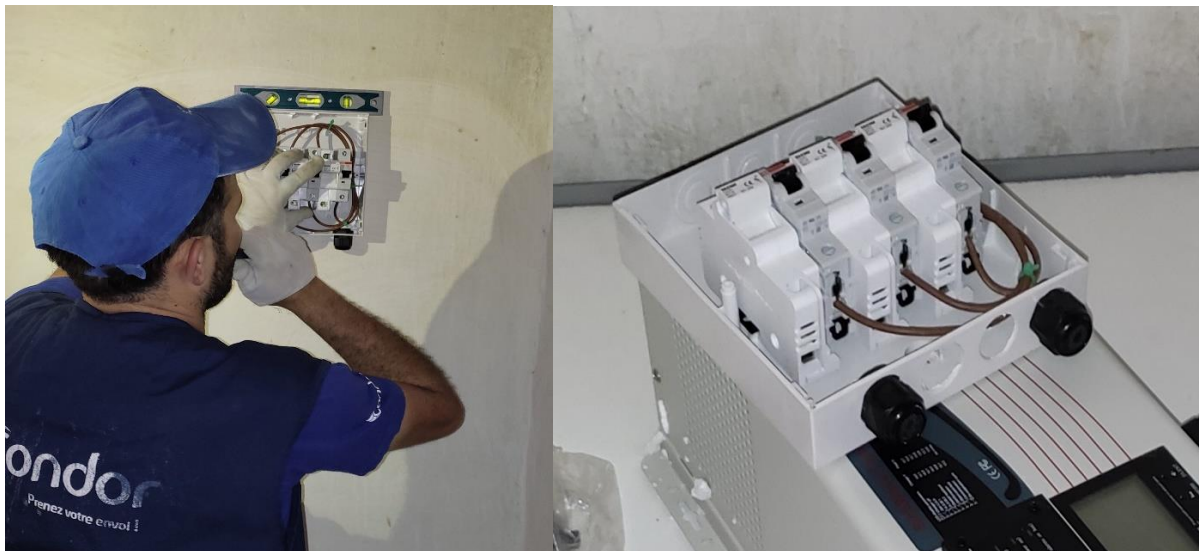
Figure 40: Boîte de jonction utilisée pour les deux systèmes
