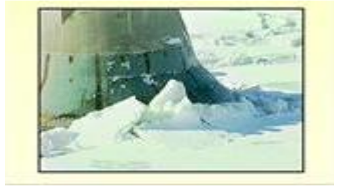
Figure II 8: Pilier de pont exposé au gel/dégel.
