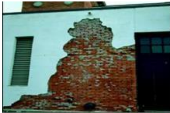
Figure II 12: Détérioration de l'enveloppe intérieure.
