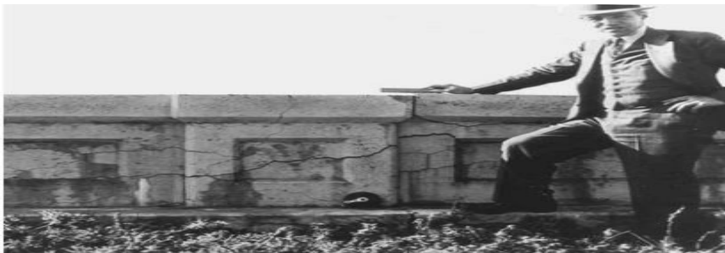
Figure II 15: Fissures causées par la Réaction Alcali-Silice rapporté par Mehta.[11]
