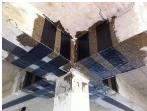
Figure II 31: dalle renforcée par des composites.
