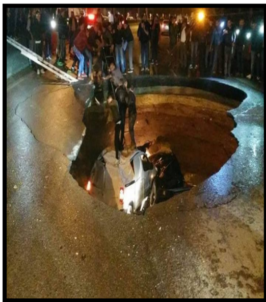
Fig.II.2 : effondrement d'une canalisation à l'origine de l'affaissement de ben aknoun,
