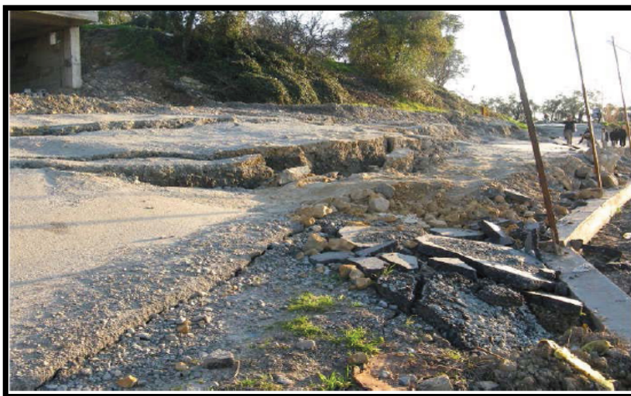
Fig.III.11 : Glissement de terrain à Azazga [11].
