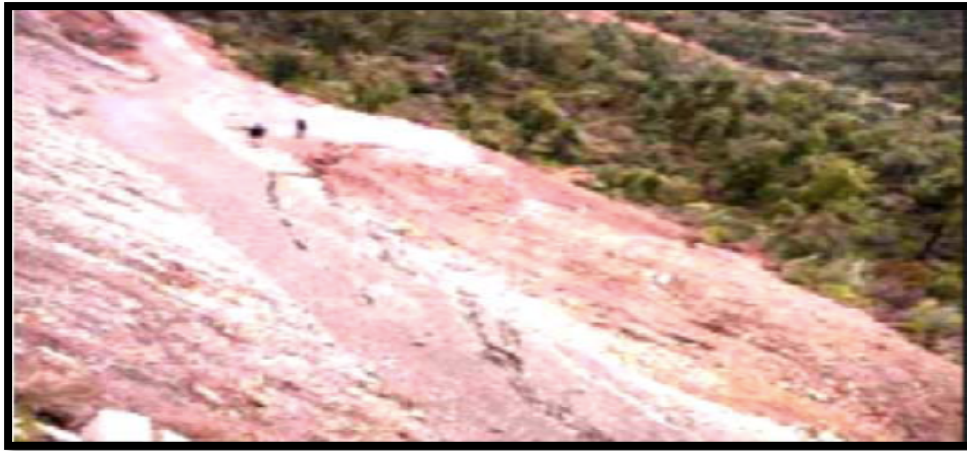
Fig.III.9 : Fissures longitudinales dans la routé affecté par le glissement.
