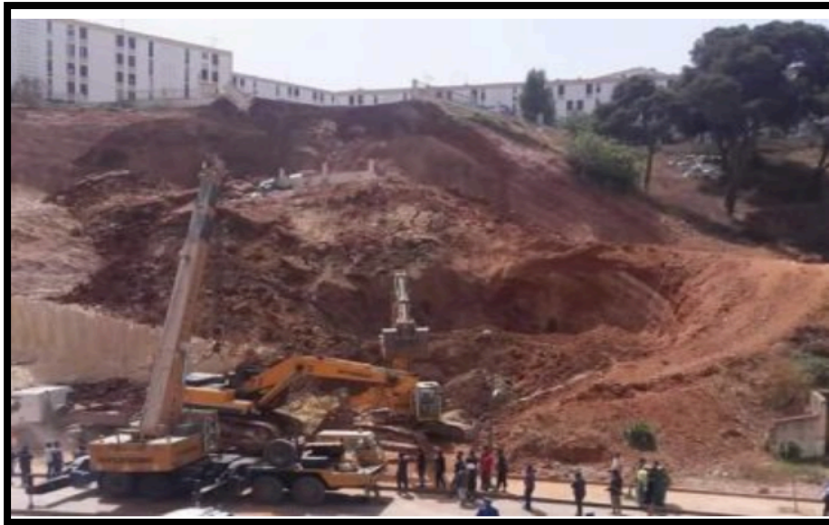
Fig.III.12 : Glissement de terrain a la rocade d'Alger.
