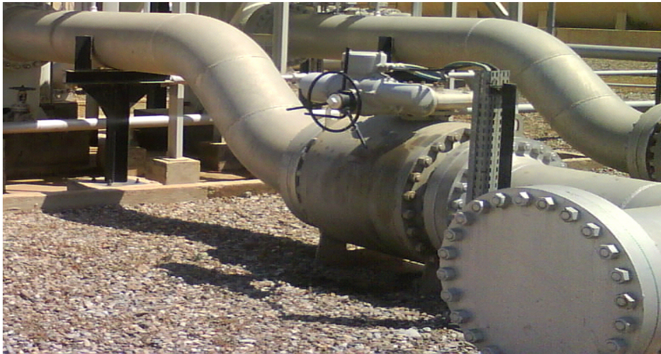
Figure I.3: La canalisation dans la station SBM
