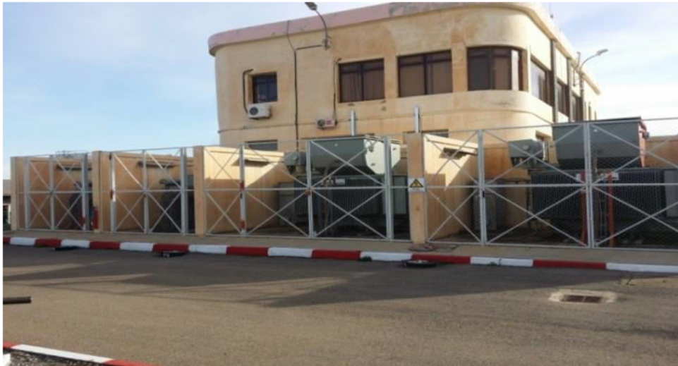
Figure 1.14: Les quatre transformateurs de la station.
