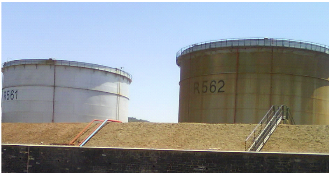
Figure 1.5 : Les Bacs de stockage de la station SBM.
